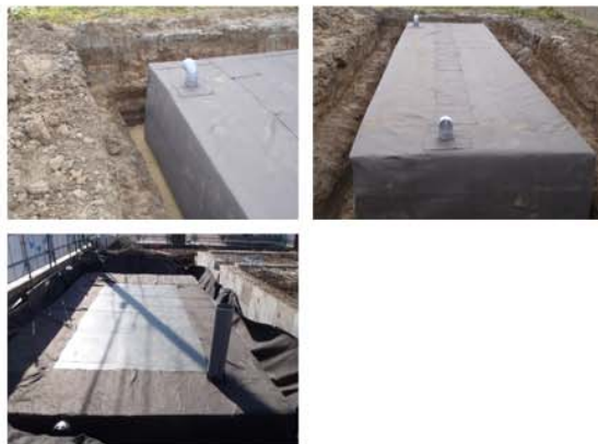
雨太郎:雨水貯留浸透槽
